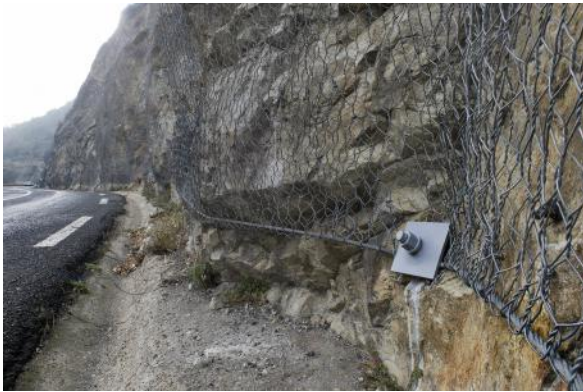
Filet de protection des éboulements au dessus d'une RN Photothèque MEEM
