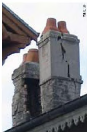
Rambervillers – Fissuration large et écoulement partiel de cheminées suite au séisme du 22 février 2003
