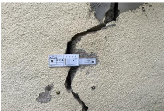
Témoin de fissuration d'une habitation suite à un retrait-gonflement argileux – Photographie MEEM
