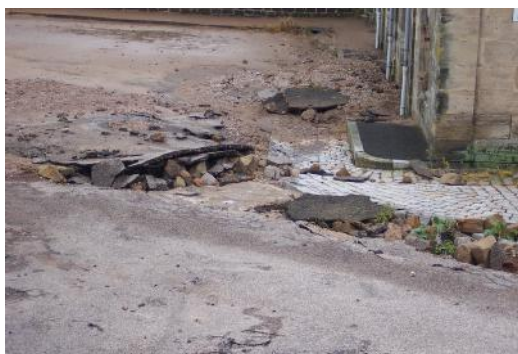
Dégâts de voirie suite à ruissellement urbain lors de l'orage de mai 2008 à Darney – Photographie commune de Darney
