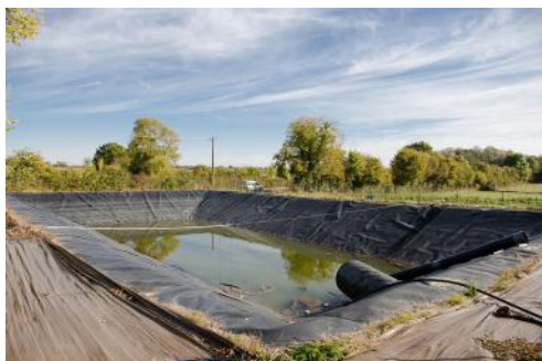
Bassin de rétention d'eau - Photographie MEEM
